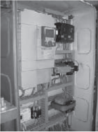
Рис. 2. Панель управления электропривода механизма подъёма с ПЧ Altivar 71
